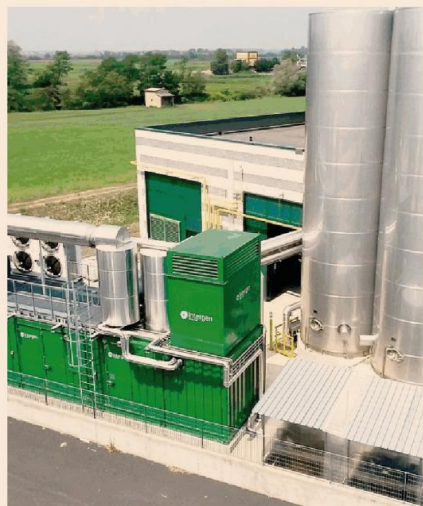
Costi. Rincari fino al 140% (In foto, impianto di cogenerazione della Igor Gorgonzola srl)
